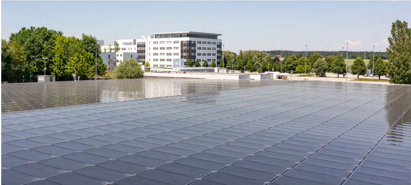
Photovoltaik-Anlage auf dem Parkdeck am Headquarter in Vilsbiburg.
